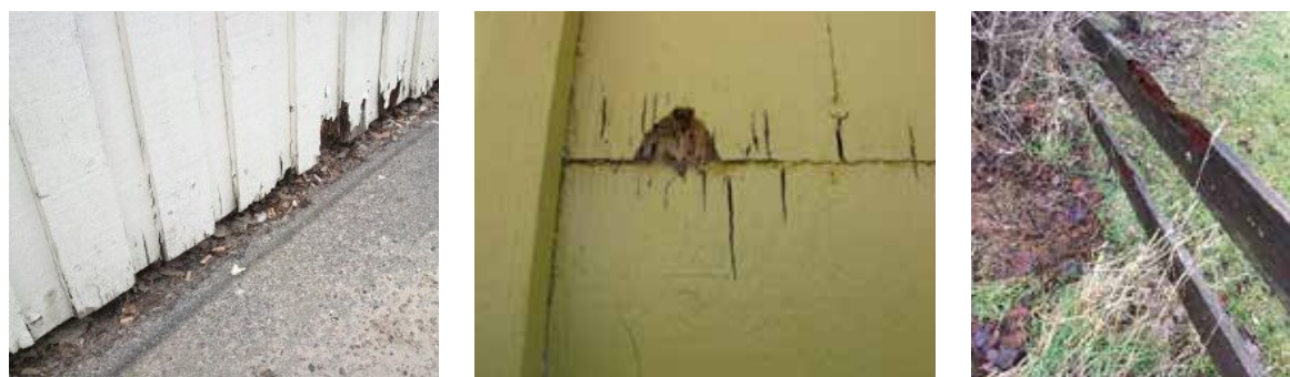
Panel nära mark och stumskarvar är exempel på dåliga konstruktionstekniska lösningar. Horisontellt, oskyddat trä är ofta mycket utsatt för väder och vind och är ett exempel på användningsområde för trä med bättre beständighet än obehandlat.
